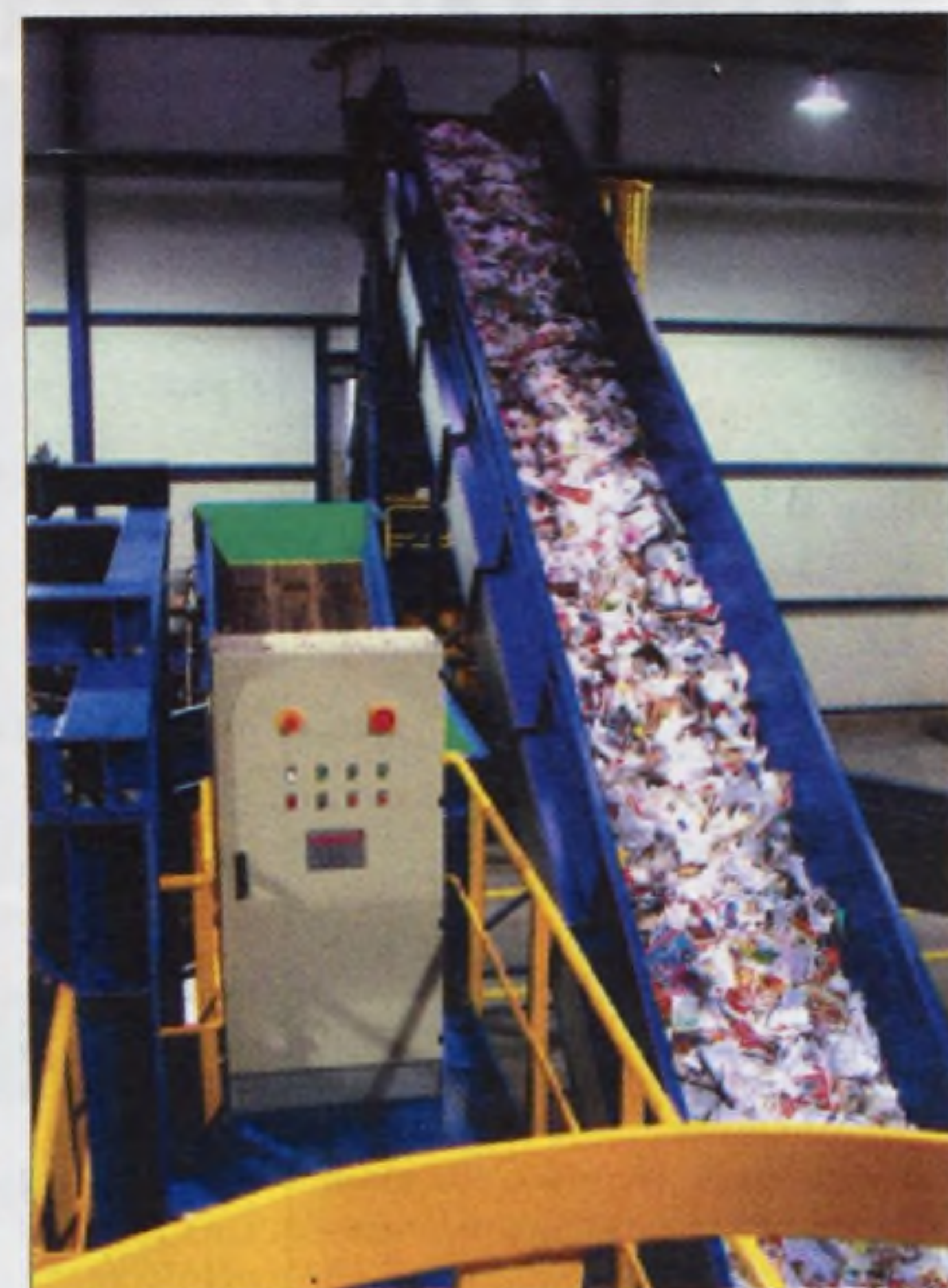
Sortownia wyposażona jest w jedne z najnowocześniejszych urządzeń.
