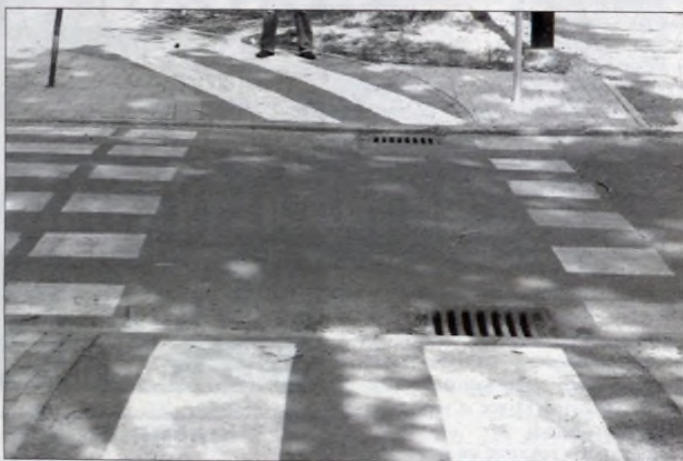
Fragment ścieżki rowerowej przy al. Andersa z fatalnie ustawioną kratką ściekową. O wypadek nietrudno.
