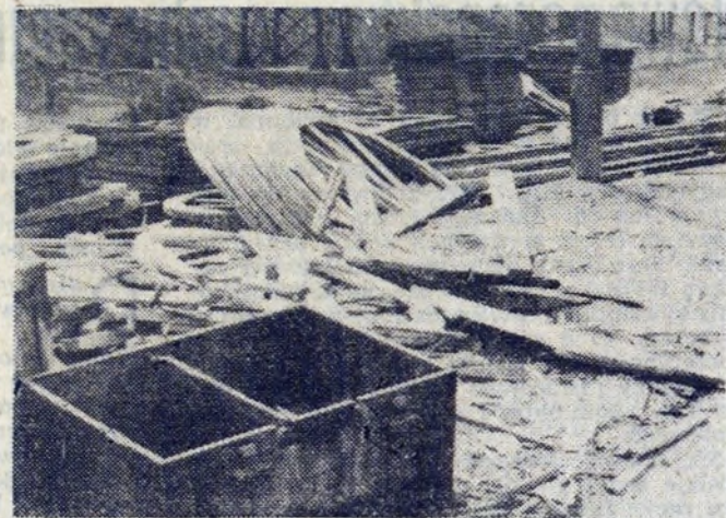
Koło Stalowni Martenowskiej stopy porzuconych w nieladzie desek i szalunków. To chyba własność budowlanych.
