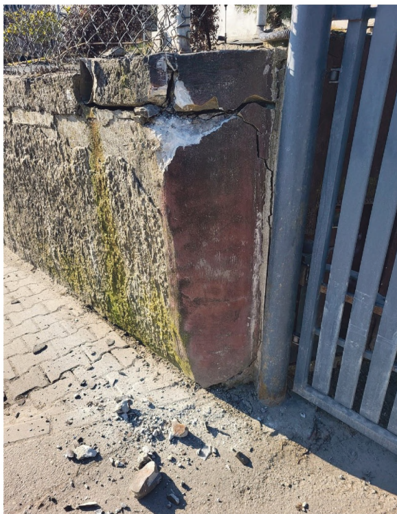
Ulica Mistrzejowicka - zniszczone ogrodzenia
