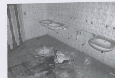
Pałac w Wadowie obecnie niszczy, uległ też dodatkowej dewastacji w wyniku podpalenia, 5 listopada 2008 r., fot. Adam Gryczyński
