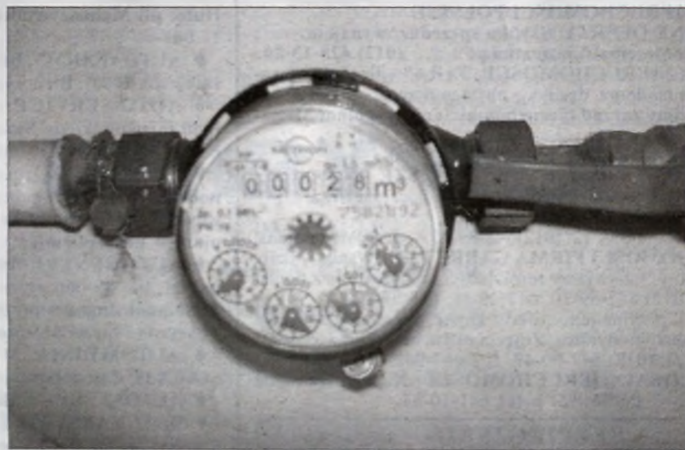
Aby rozliczać się z MPWiK jednym z podstawowych warunków jest zainstalowanie wodomierza przy każdym punkcie czerpalnym wody.
