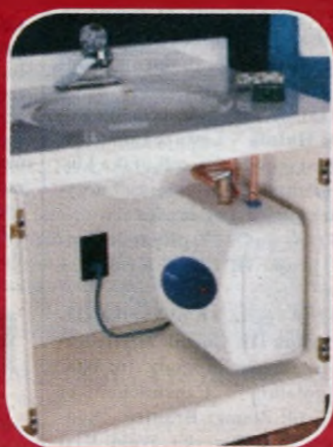
Rys. 3 – Mały podgrzewacz elektryczny TiShape zainstalowany pod zlewem
