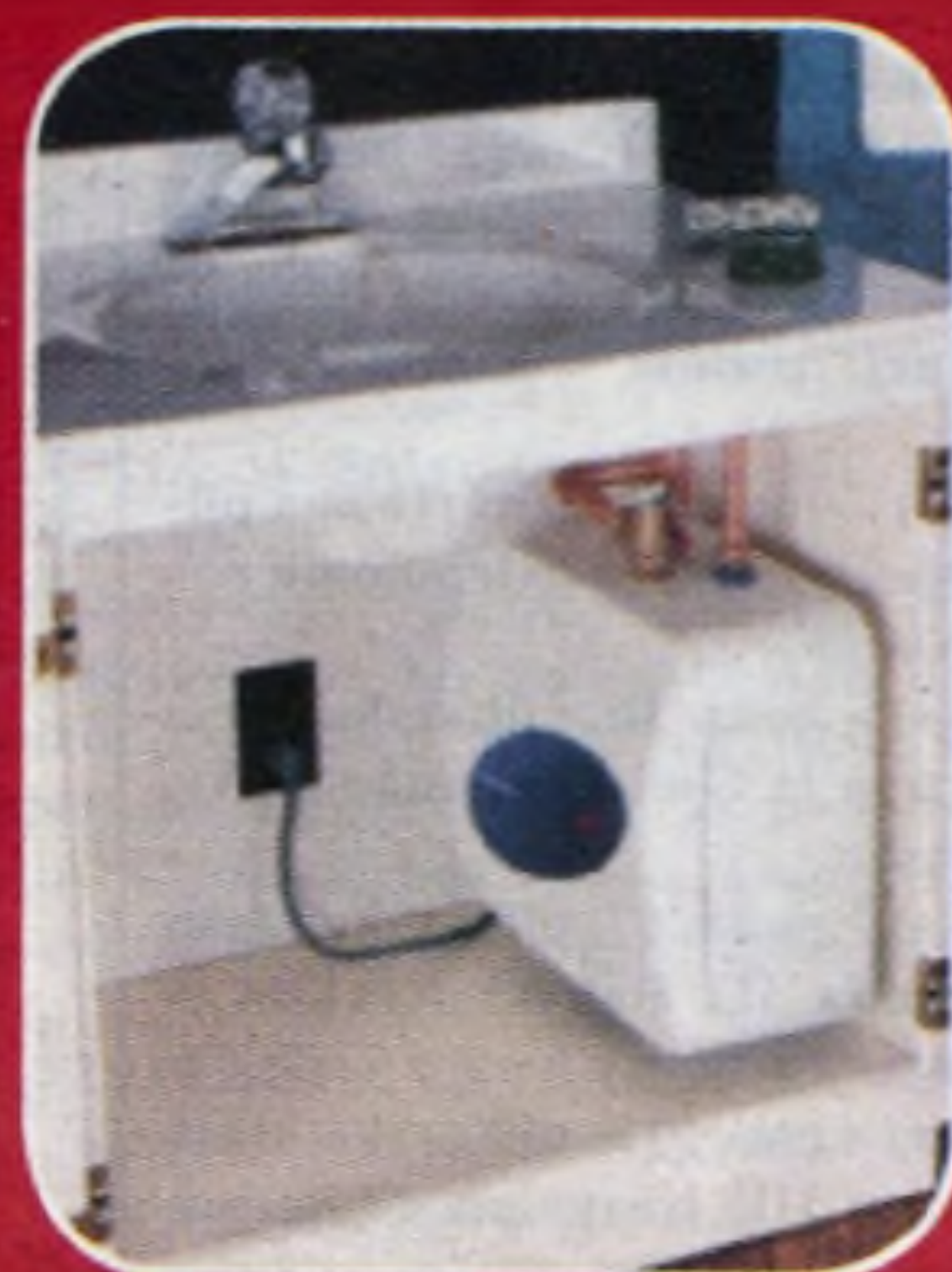
Rys. 3 – Mały podgrzewacz elektryczny TiShape zamontowany pod zlewem
